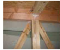
外壁・柱とも大きく変形、さらに筋交いがはずれている。
